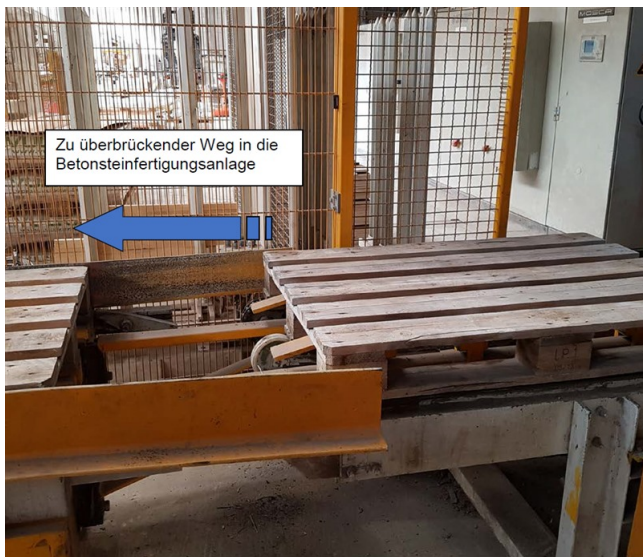
Ende der Kettenförderung - Anfang Übernahme durch Palettenaufnahmeschienen
