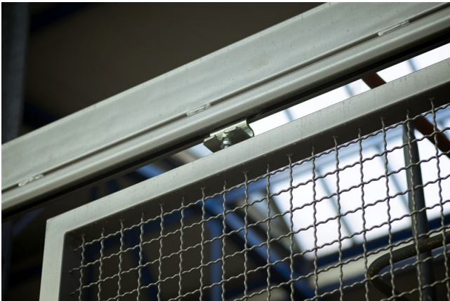
Gitteraufhängung über die gesamte Bühnenlänge
