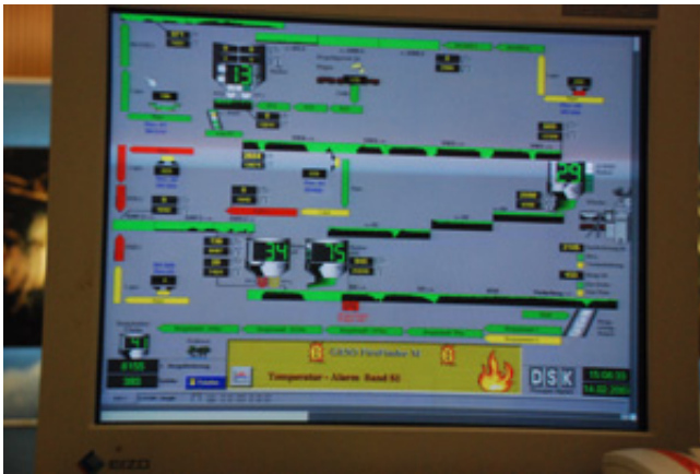
Monitor mit Alarmhinweis
